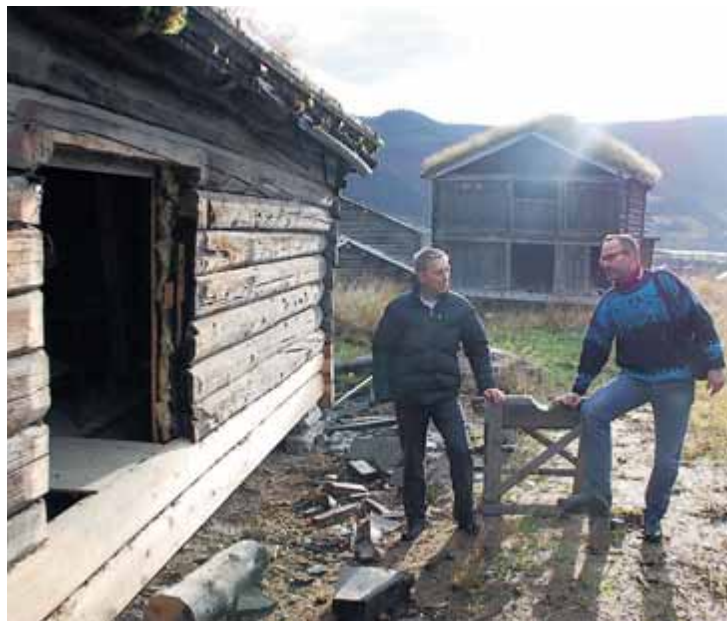
Sjokkert: – Noe av det verste forfallet jeg har sett på et fredet anlegg, sier kulturhistoriker Sjur Harby (til høyre).
